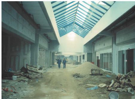
▲ Ein Einblick in die Bauarbeiten vor 27 Jahren: Hier war noch nicht an die Eröffnung des Bethanien-Centers zu denken.
